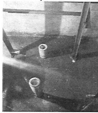
Foto 14. Agua en el foso (pit).
