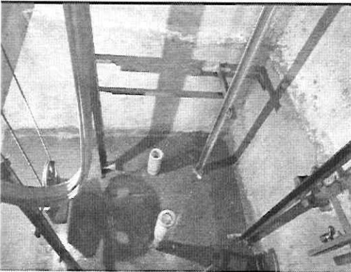
Foto 13. Agua en el foso (pit).
