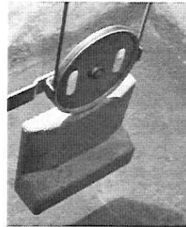
Foto 12. No existe el dispositivo de control de rotura o aflojamiento del cable del limitador.
