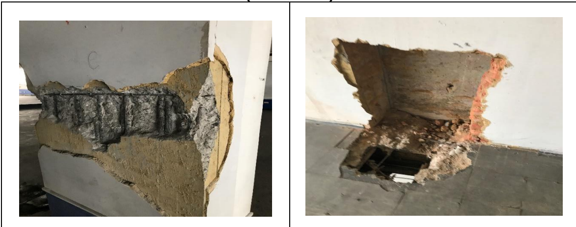
Gráfico No. 18 - Registro fotográfico del estado actual del Edificio El Comendador (11-oct-2023)
